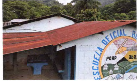
Foto 4: La cubierta de lámina del área de cocina y de pila ameritan la sustitución de láminas actuales con lámina troquelada calibre 26.
