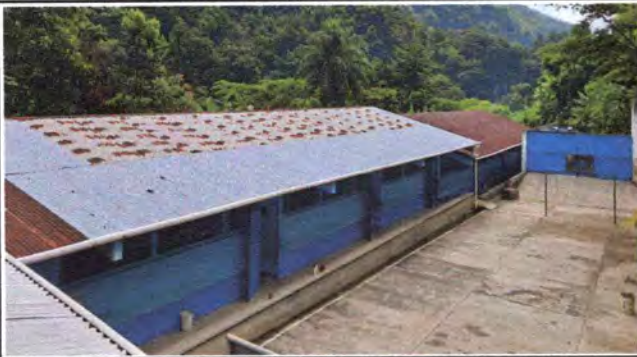
Foto 1: Módulos 1 y 2 con cubierta de lámina de zinc con alto nivel de oxidación, el cual será sustituida con lámina troquelada calibre 26.
