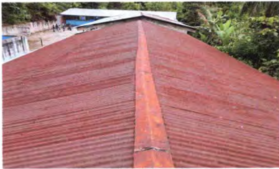
Foto 3: Cubierta de lámina de zinc del módulo 2, por su estado de oxidación amerita sustitución.
