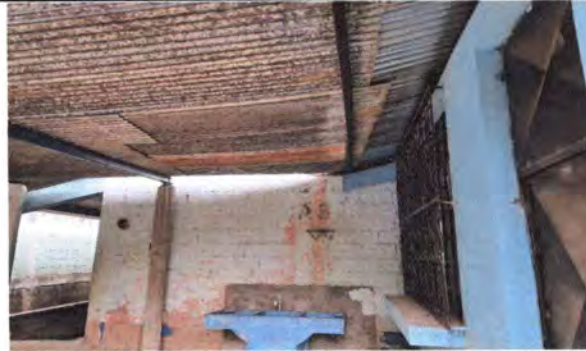
Foto 2: Cocina: Estructura de Techo en mal estado (pandeado), los cuales se sustituirán por Costaneras galvanizadas de 2 x 4.
