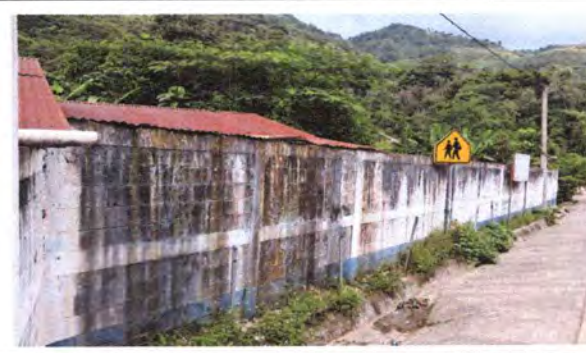
Foto 4: Muro Perimetral descolorido, al cual se les estará aplicando pintura
