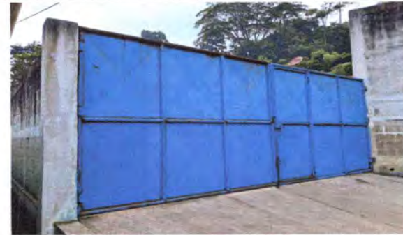
Foto 6: Vista interior del portón de ingreso, en el cual se evidencia la corrosión, razón por la cual se le dará mantenimiento y aplicación de pintura anticorrosiva.
