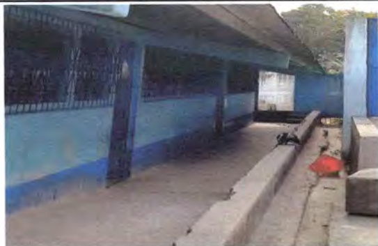
Foto 3: Pared exterior de aulas de uno de los módulos, al que se le dará mantenimiento y aplicación de pintura. Módulo 1 donde también se instalará chapas nuevas en sustitución de candados.
